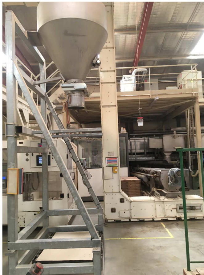
Installation de débactérisation chez la structure 9 (spirajoule)
